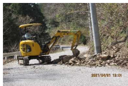
【林道における小規模崩落】
