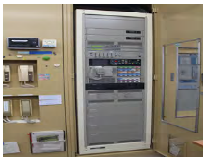
【非常用放送設備】
