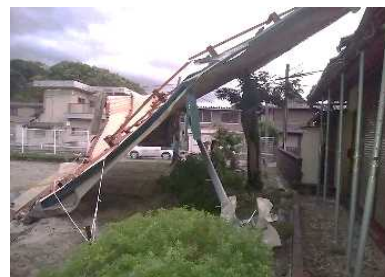
【被災した防災情報伝達システム屋外子局】
