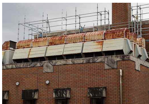
【老朽化した空調機器(室外機)】
