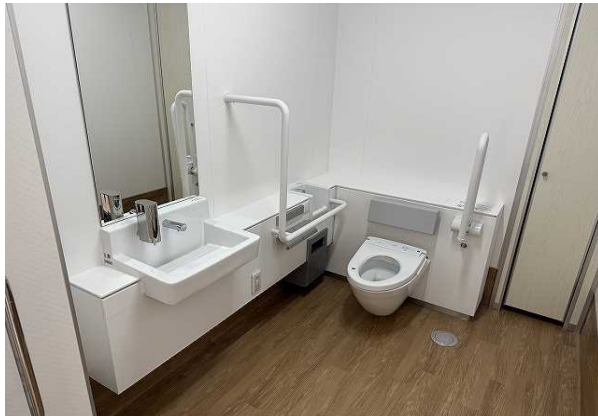
【伊吹山中学校体育館の多機能トイレ】
