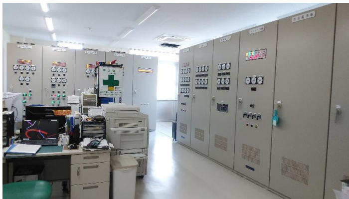
写真－５ 場内制御機器整備状況
