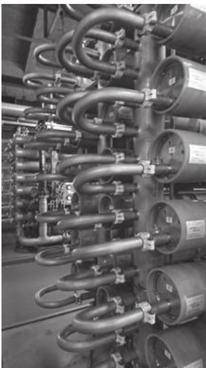
耐震化を進める本市場浄水場のRO膜による硬度処理設備
