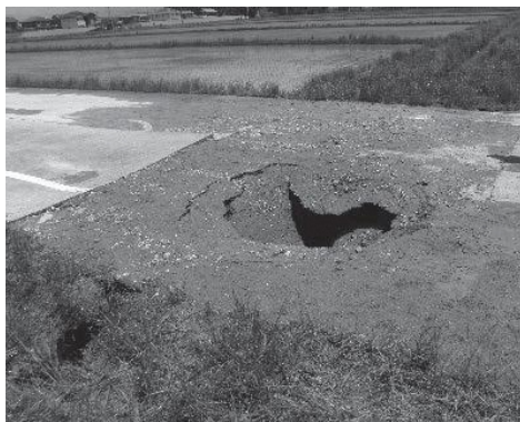
送水管の破損による道路の陥没 (宇賀野地先)
