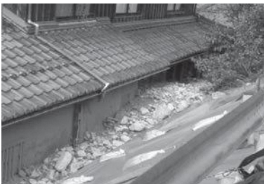
伊吹地先被災状況(令和6年9月撮影)
