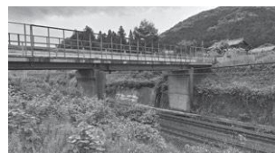
老朽化が進む長久寺跨線橋
