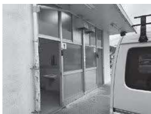
近江長岡駅トイレ。出入口前がJR関係車両の駐車場であるため目隠し状態。安全とは言い難い。
