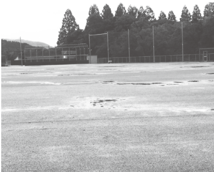
改修された6月3日降雨後の大東中学校グラウンド。まだ補修が必要。
