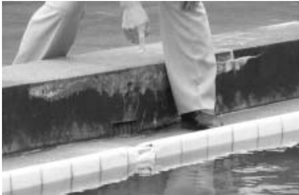
大原小学校プール破損箇所
