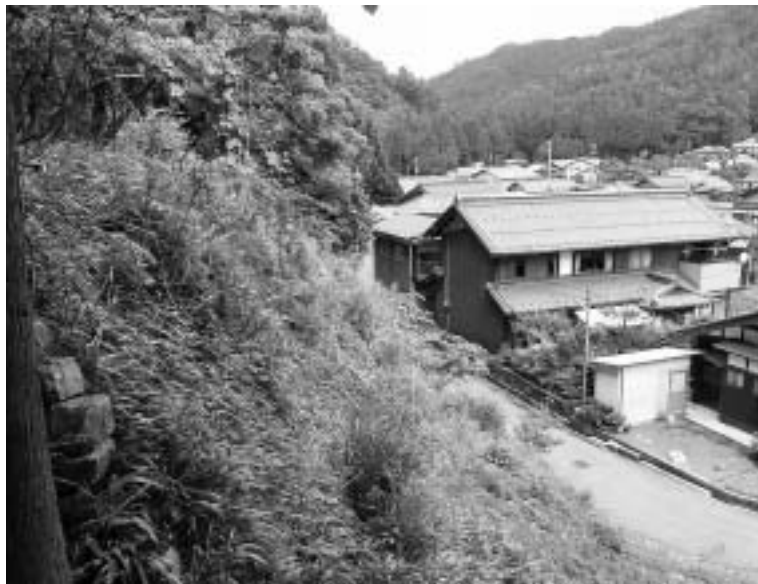
県事業から漏れた下丹生地先の急傾斜地
