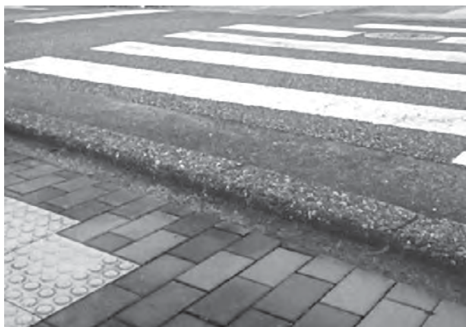
車いす等利用の方の移動障がいとなる段差と 摩耗している点字ブロック (坂田駅前 横断歩道箇所)
