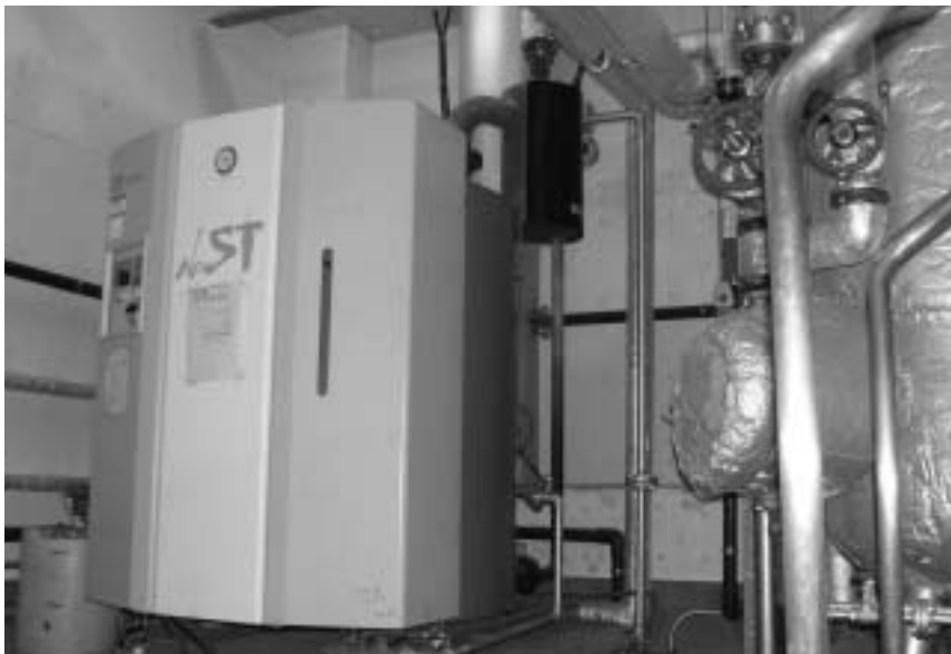
米原給食センターボイラー室
