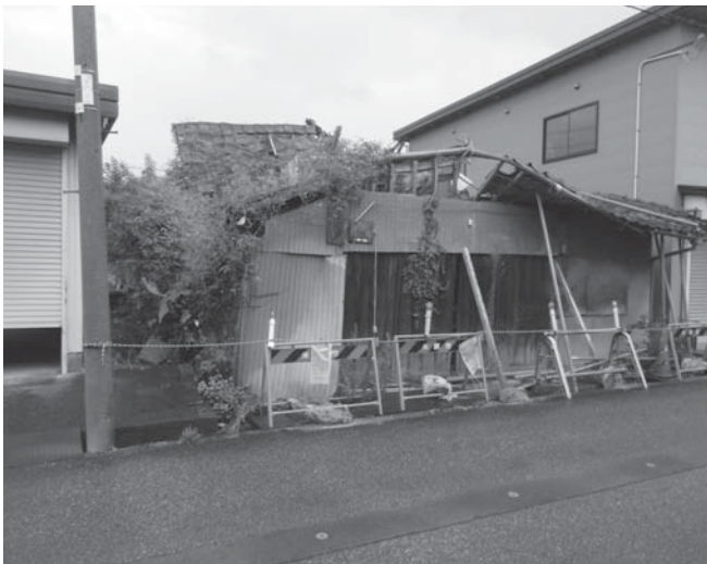
長岡自治会内の空き家の状況
