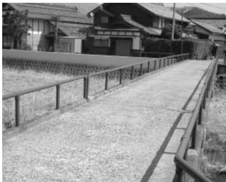
天野川 昭和橋 破損箇所
