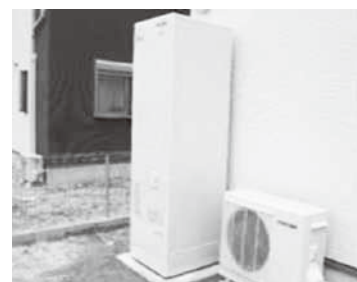
一般的なエコキュート設備
