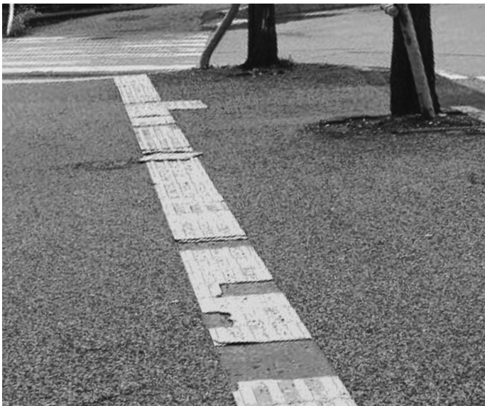
米原駅前の歩道(点字ブロック)の著しい傷み
