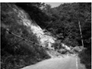
法面崩壊の林道七曲線（9/24現在）
