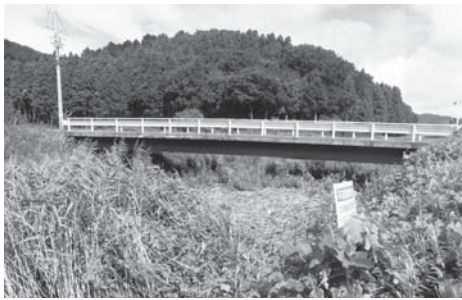
老朽化が進む農道橋（黒田川）
