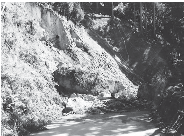
平成25年9月に土砂崩れが発生した林道（上丹生）
