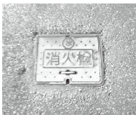
道路の地下式消火栓
