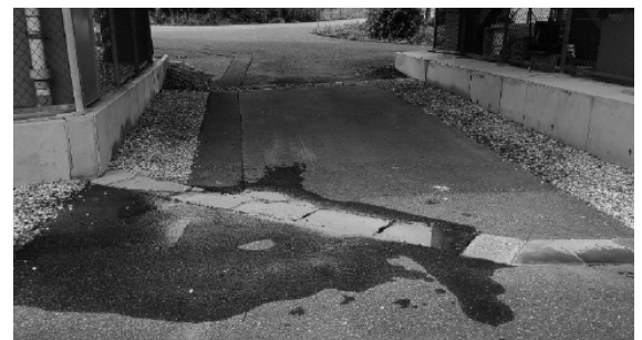
水道管からの水漏れの様子
