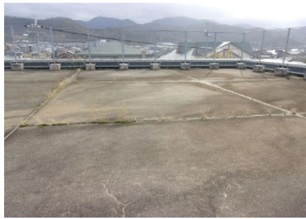
【屋上の劣化状況】
