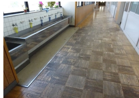
【内部（床）の劣化状況】
