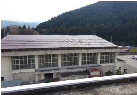
【屋内運動場（外壁）の劣化状況】
