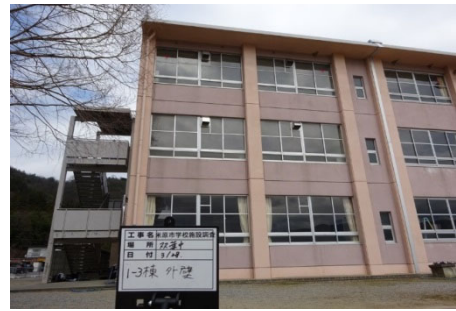
【外壁の劣化状況】
