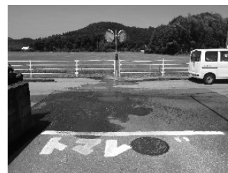
▲道路上に水が出ている事例
