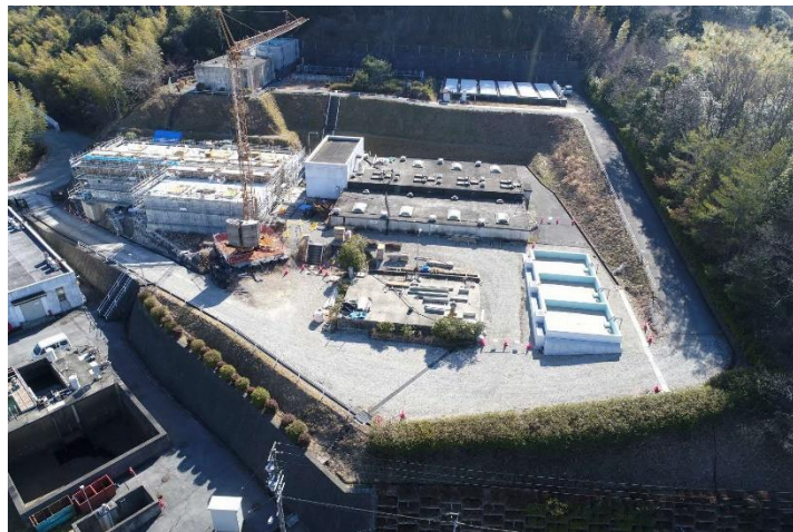
礫浄水場の全景
