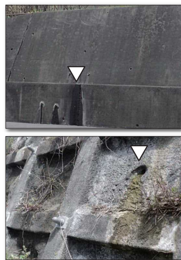
地下水の流出
