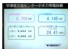
甲津原交流センター 小水力発電設備
