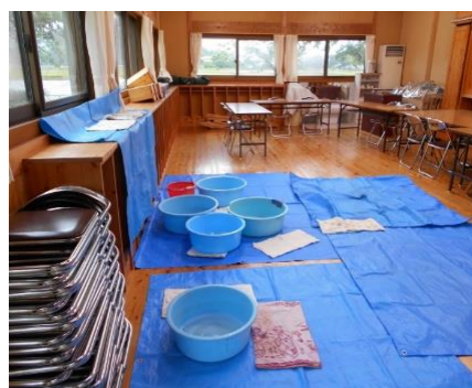
山東幼稚園の雨漏れの様子
