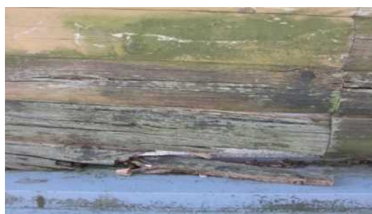
外壁老朽化状況
