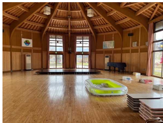
雨漏れ対応状況（かもんほーる）
