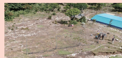
5合目に設置したドロップネット
