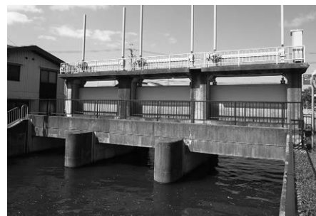
▲市内には入江と磯の2カ所にポンプ場があり、琵琶湖の水位を見守っています(写真は入江川樋門)
